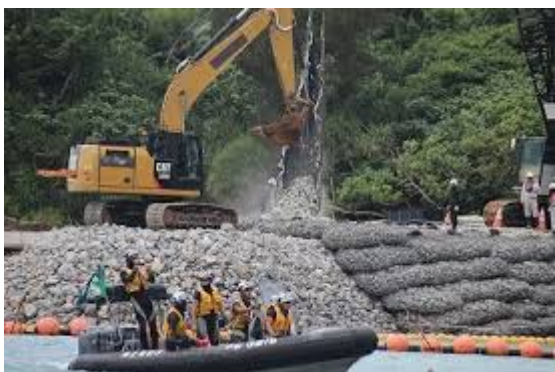
沖縄県名護市東海岸米軍キャンプ・シュワブ沿岸域への「K9護岸」工事を始めた防衛省。沖縄県は、工事差し止め訴訟で対抗する。
